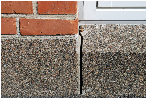
Endnu en sokkelrevne på forsiden af bygningen. Der forekommer mange flere end viste, men dem der er vist i rapporten er nogle af de værste.
