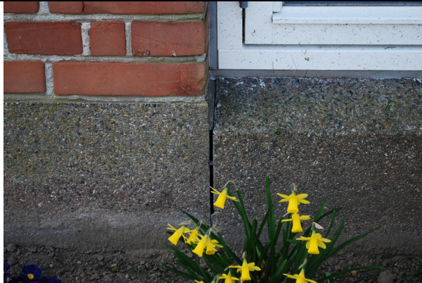
Sokkelrevne på forsiden af bygningen.
